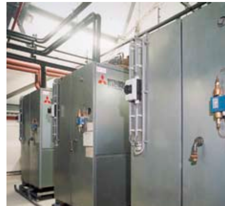
WR2 Buitenunits in binnenopstelling
